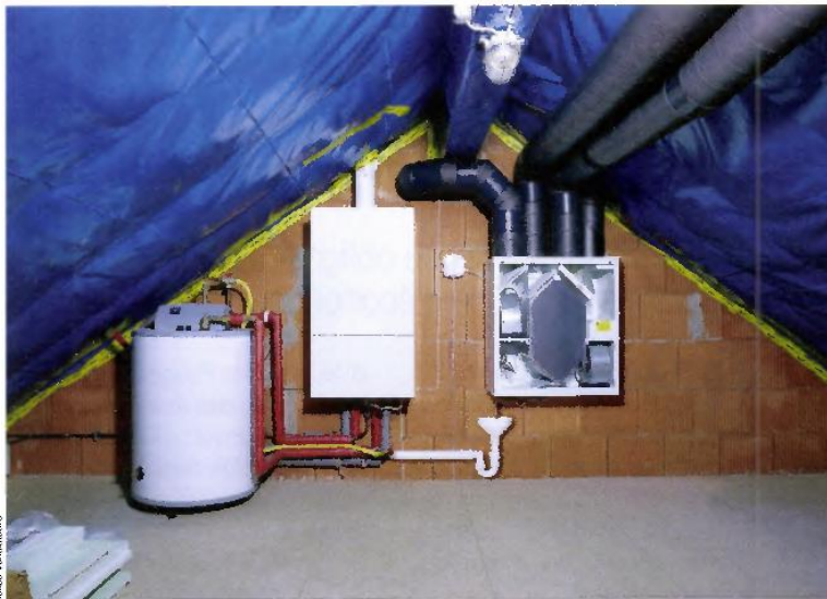
► Centrale double flux installée dans les combles, conçue pour un logement de type T5 avec 2 salles de bains, 2 WC et 1 buanderie, débit de base 150 m 3 /h, pertes de charge 150 Pa, vitesse 4.
